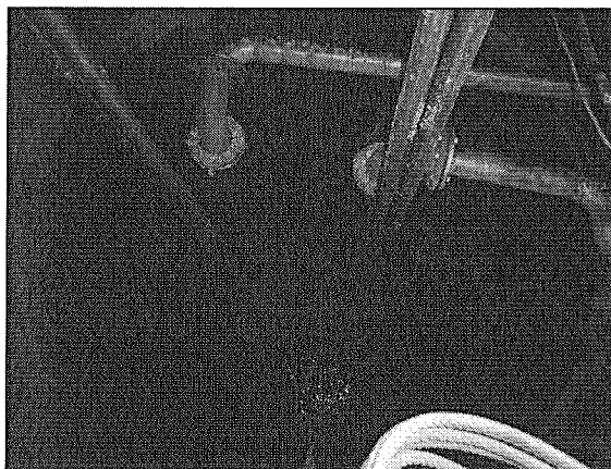
1. sz. átemelő (végátemelő) akna
