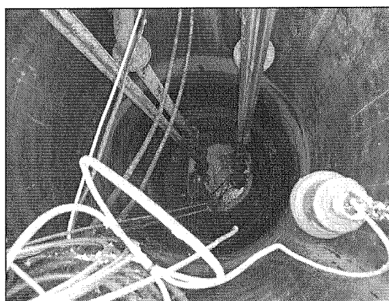
3. sz. átemelő akna
