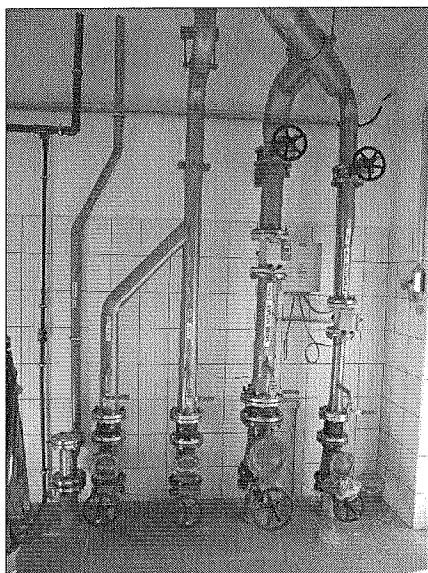
Nyers szennyvíz bejövő vezeték
